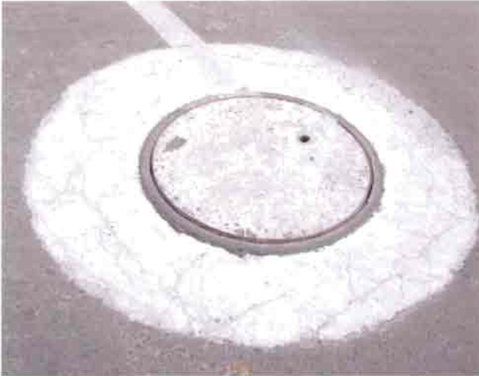
Fotografía N° 17: Satélite presenta múltiples fisuras, además de un desgaste prematuro.
