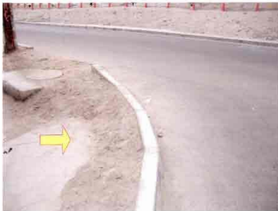
Fotografía N° 18: Intervención de acera, por la instalación de soleras, no fue reparada
