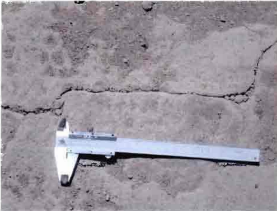
Fotografía N° 13: Fisuras en pavimento (Belén)
