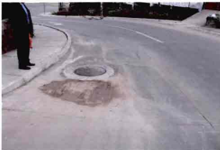
Fotografía N° 12: Intervención del pavimento con resultados de asentamientos localizados de la carpeta asfáltica (sector La Lisera)
