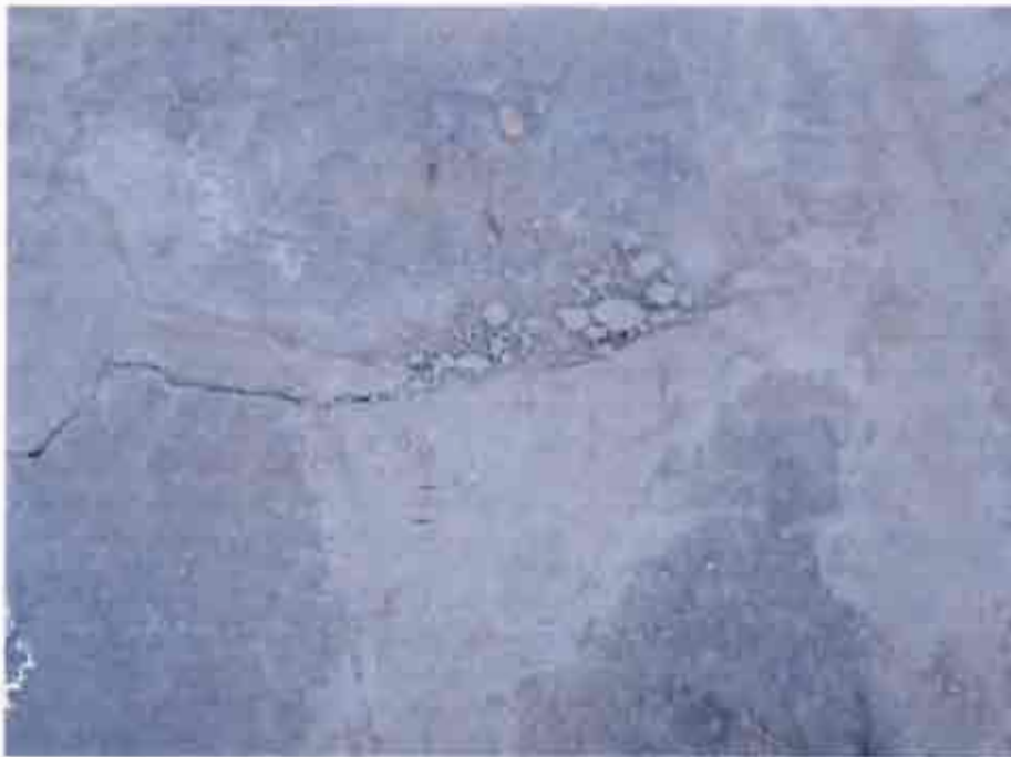
Fotografía N° 14: Fisuras en pavimento (Sacoroma)
