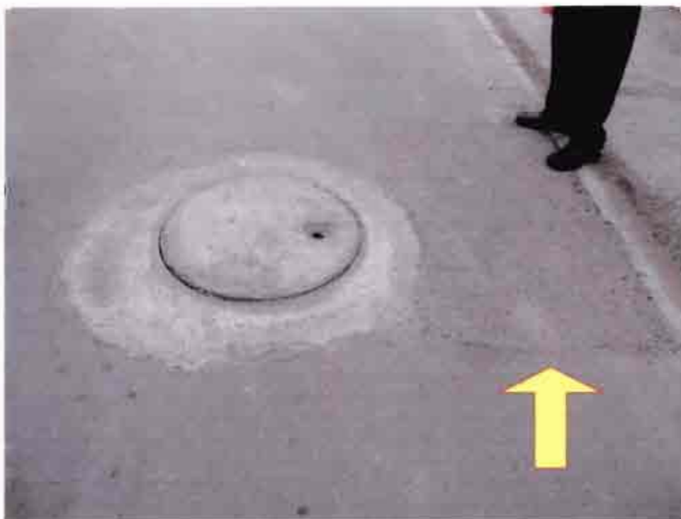
Fotografía N° 11: Parche de distinta materialidad (sector Saucabe)
