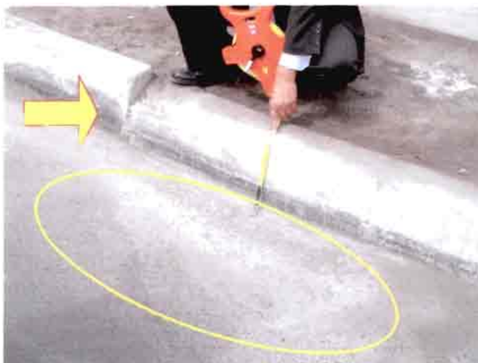
Fotografía N° 16: Solera con arista faltante y pavimento con leve asentamiento.
