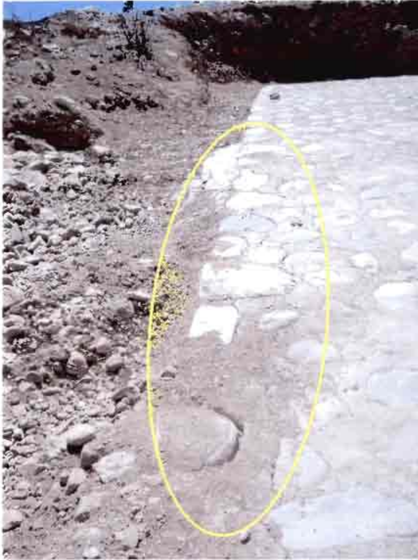
Fotografía N° 15: Deformación y grietas longitudinales (Ticnamar).
