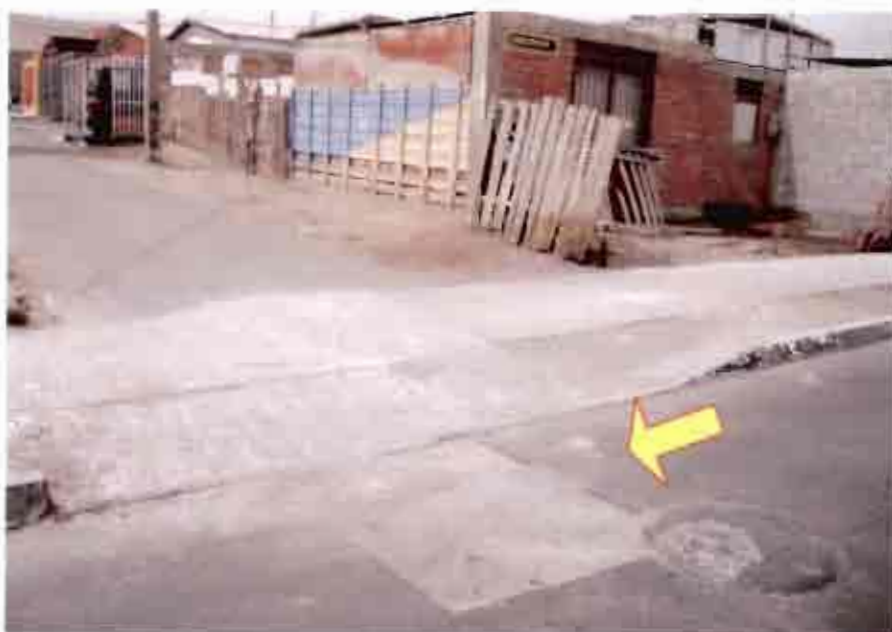
Fotografía N° 19: Intervención del pavimento sin reparación
