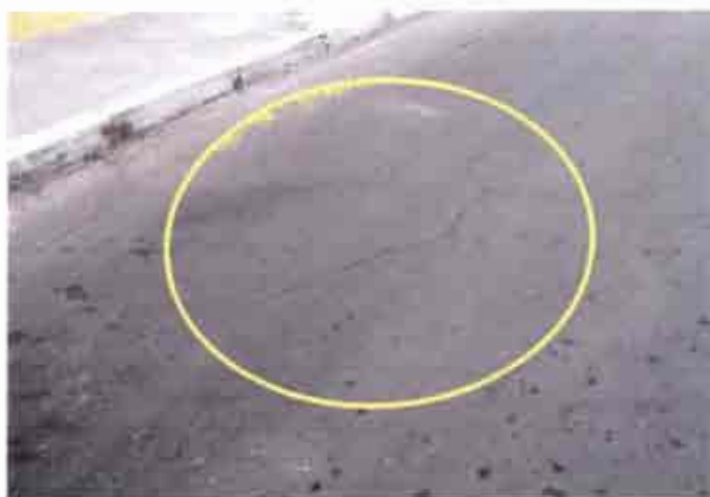
Fotografía N° 5: Fisura tipo "piel de cocodrilo"
