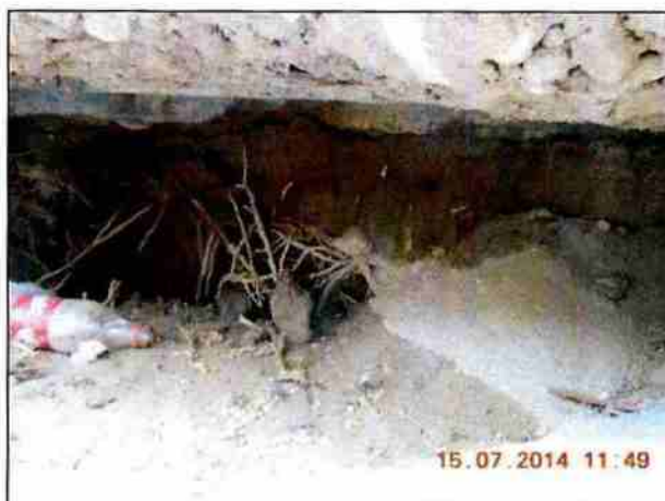
Foto N° 2 Perdida de base de pavimento de calzada.
