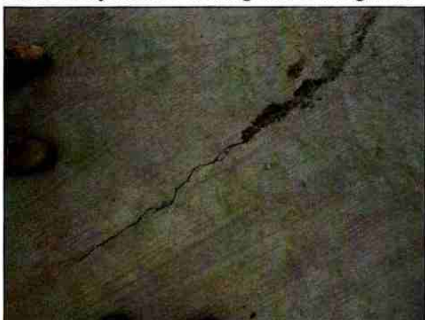
Foto N° 3 Fisura en calzada de hormigón.
