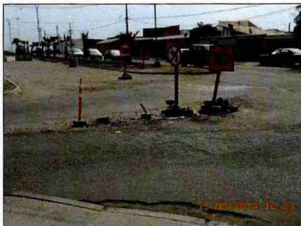
Foto N° 6 Soporte de la señalización lastrado con bases de hormigón y piedras.
