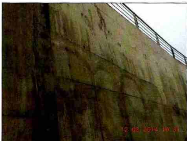
Foto N° 1 Muro con junta de hormigonado irregular.
