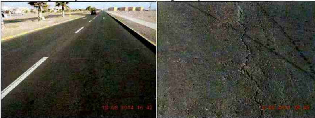
Foto N° 5, grietas transversales y longitudinal, entre Diaguitas y Andes.
