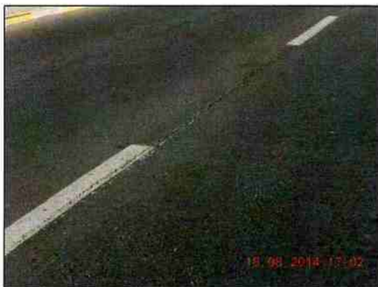
Foto N° 13, grieta longitudinal entre La Provedora y Llacolen.
