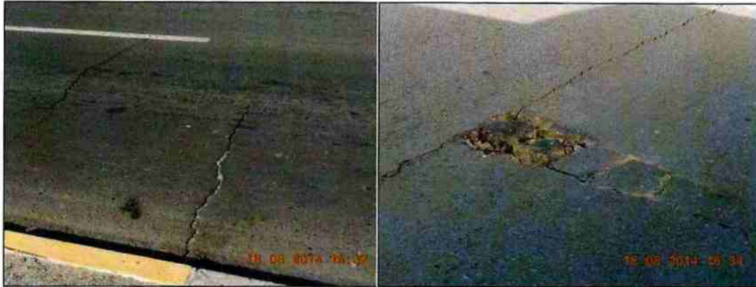
Foto N° 1, grieta transversal entre rotonda Juan Guillén y Diaguitas.
