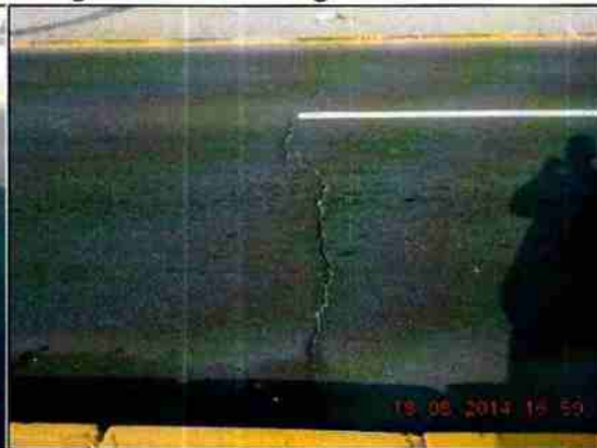
Foto N° 12, grieta transversal entre Amador Nehgme y La Proveedora.
