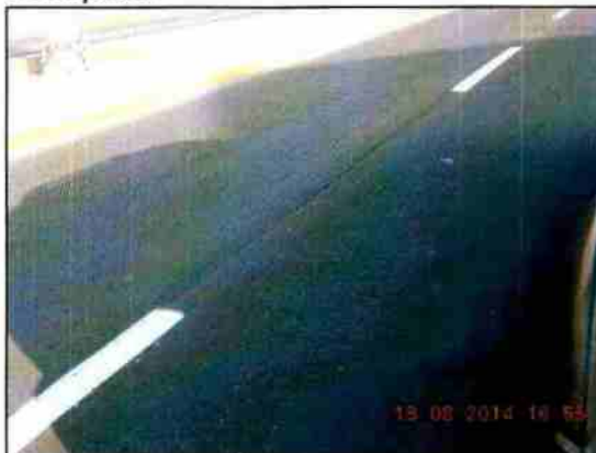
Foto N° 9, grieta longitudinal entre Tocopilla y Amador Nehgme.
