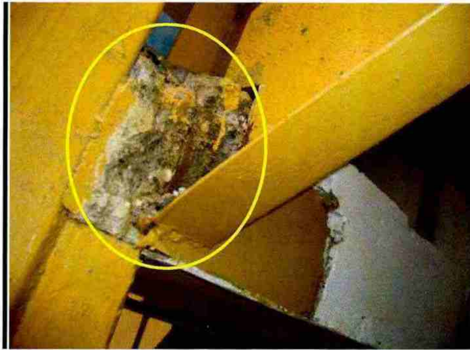
Fotografía 3: Elementos sin aplicación de anticorrosivo y esmalte.
