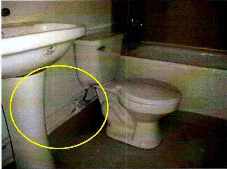
Fotografía 5: Cañerías de agua potable a la vista.
