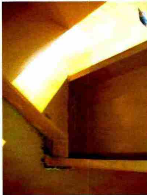
Fotografía 10: Unión base limón con losa descanso.
