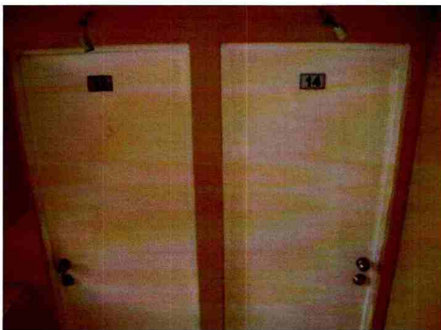
Fotografía 2: Deficiencias en pintura de puertas.
