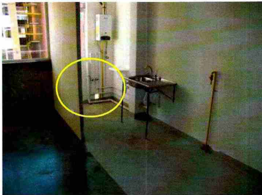
Fotografía 6: Cañerías de agua potable a la vista.
