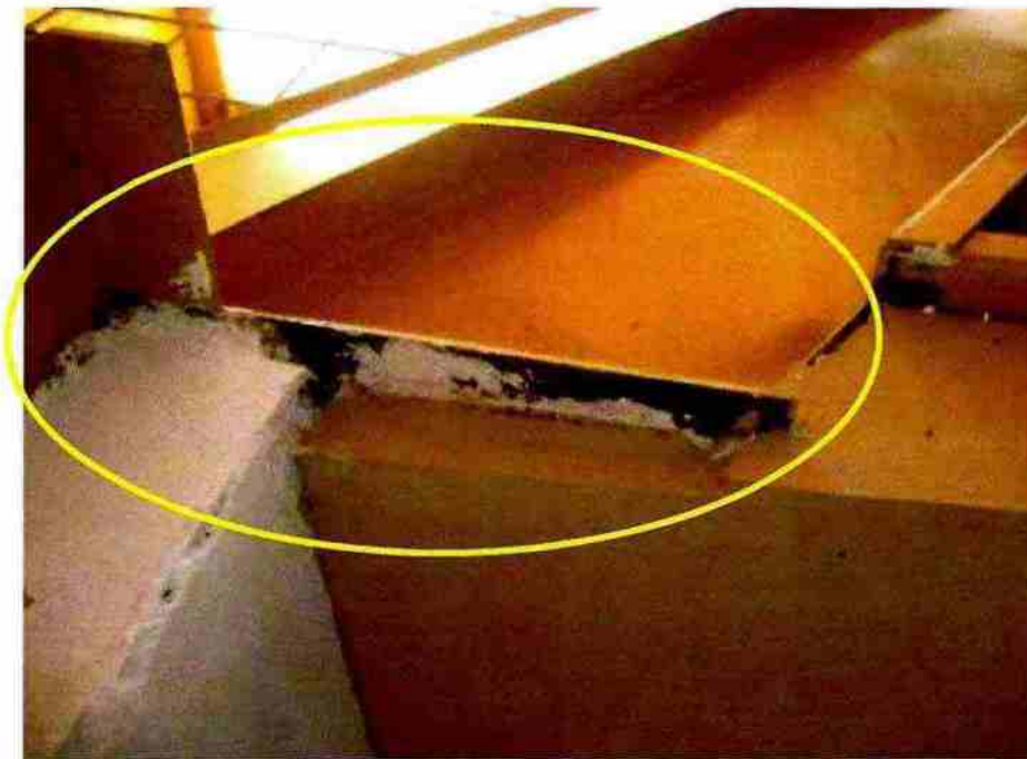
Fotografía 4: Elementos sin aplicación de anticorrosivo y esmalte.
