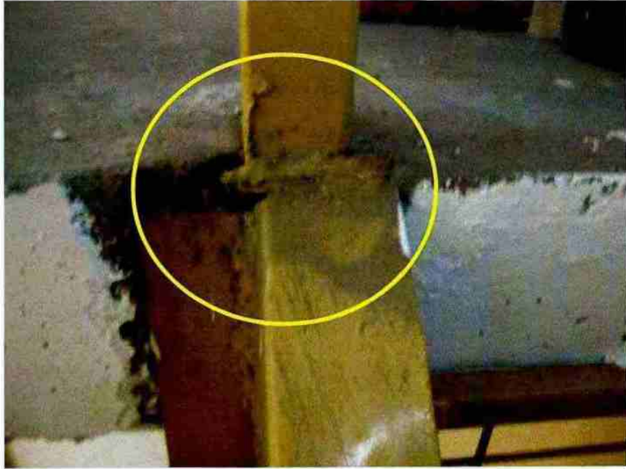
Fotografía 11: Unión Balaustro-limón, con fierro estriado soldado.
